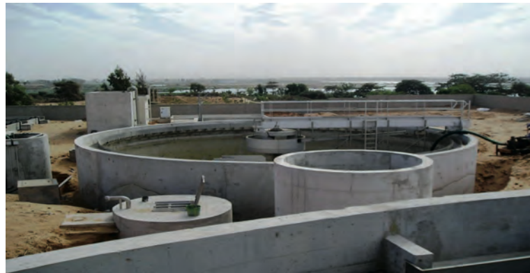
Photo n° 12 : ouvrages de station de traitement et d'épuration
