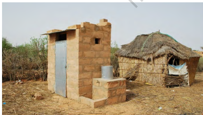
Photo n° 7 : ouvrage individuel (VIP double fosse)
