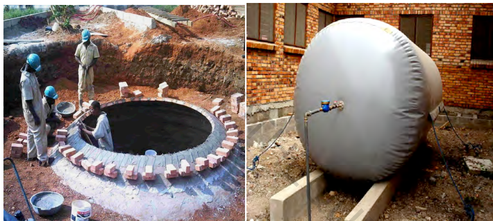
Photo n° 10 : ouvrage domestique de production de biogaz
